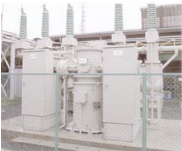
72/84kV受変電用超小型ガス絶縁開閉装置 写真ご提供:日新電機株式会社 前橋製作所様
