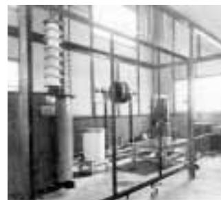
120キロボルト試験用変圧器（手前）と150キロボルト衝撃電圧発生装置
