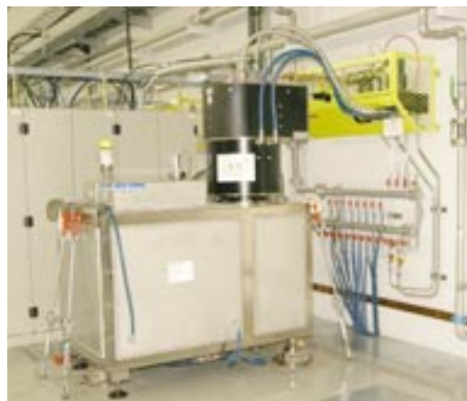
電源装置は左写真の壁面裏に約70台設置されています
