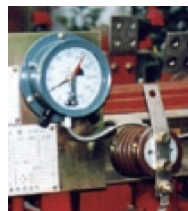
▲被災した変圧器 ダイヤル温度計はしっかり機能していました
