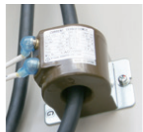
▲低圧貫通形CTの設置例 ケーブルを貫通口に通しています。
