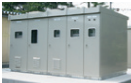
▲配電盤の一例
