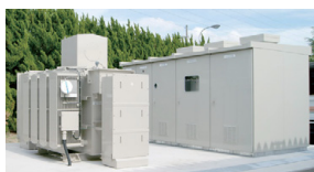
▲特別高圧受電設備の一例
