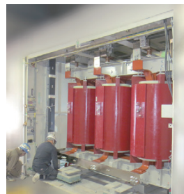
▲更新にあたり3000kVAの変圧器(既設品)があったスペースに納まった4000kVAのリショーキャスト変圧器
