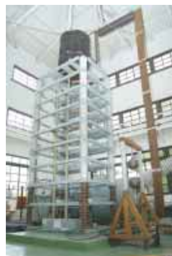
▲120万ボルト衝撃電圧発生装置
