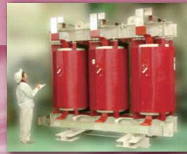
▲4000kVA 大容量モールド変圧器
