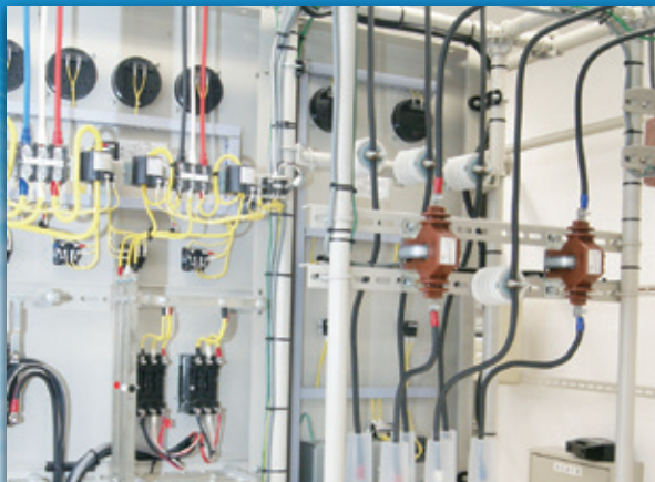
▲訓練用の配電盤(人財開発センター内/大阪市西区)
