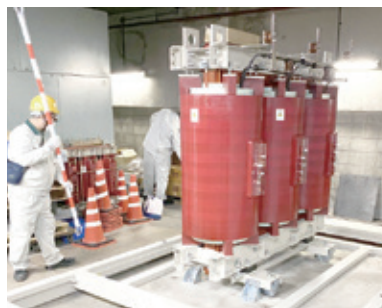
▲所定の場所にセットされた変圧器
