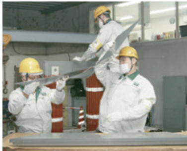
▲コイルをセットするため、いったん上部の鉄心(薄い鋼板)を外します。
