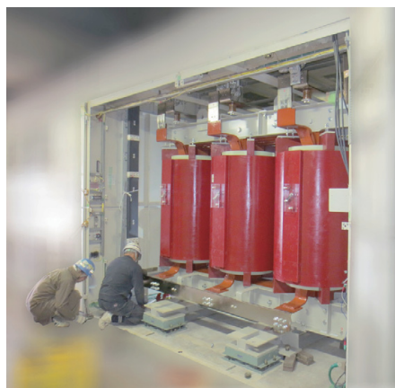
▲図2 3000kVAのスペースに納まった4000kVA変圧器
