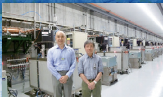
▲線型加速器に高周波電力を供給する装置(クライストロン)ここにリショークキャスト パルス変圧器をご採用いただいております。
